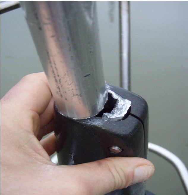
Der Materialermüdungsbruch der Rollanlage
